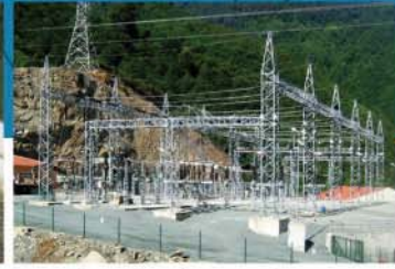
Sarmaşık II HES 154 kV TM - Trabzon
