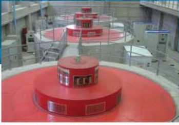
Pınar Hidroelektrik Santrali - Adıyaman
